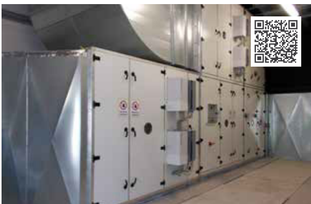
Entwärmung der Konverterstation DolWin 3, 4 Free Line Geräte mit Luftvolumenströmen von 50 000 m 3 /h, Kälteleistungen von 320 kW und integrierten Elektrolufterhitzern.
