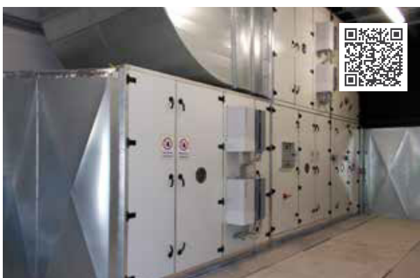
Entwärmung der Konverterstation DolWin 3, 4 Free Line Geräte mit Luftvolumenströmen von 50 000 m 3 /h, Kälteleistungen von 320 kW und integrierten Elektrolufterhitzern.
